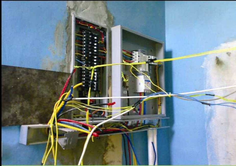
الأحمال الزائدة تشكل 25٪ من أسباب الانقطاع الكهربائي في قطر Unauthorized service restore. Effect: Un accountable load and equipment damage
